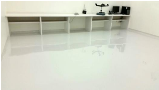
Recubrimientos epoxicos y poliuretanos
